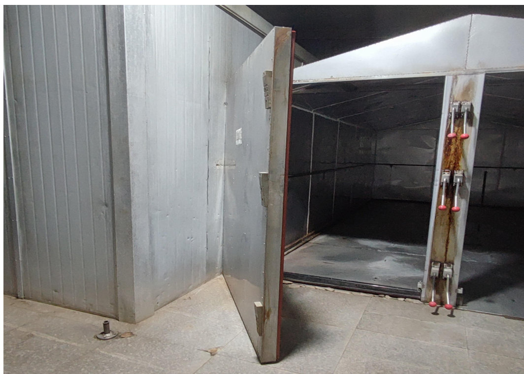
图 2 蒸房左扇门能开启最大角度照片
